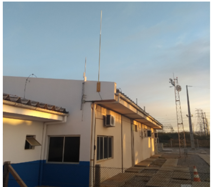
Fig. 4. Instalados dos sensores na rede de média tensão (à acima) e antena do receptor (à abaixo).
