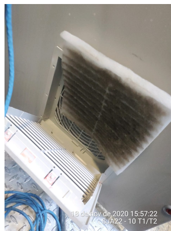
Figura 10: Filtro de painel necessitando ser trocado
