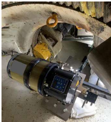
Figura 4 – Sistema de lubrificação automática instalado no aerogerador
